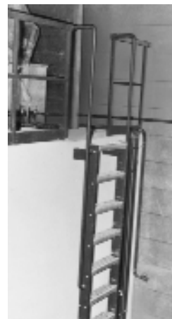
Aufstieg zu wenig begangener Bühne. Die Leiterstufen bestehen aus feuerverzinktem Gitterrost. An den Stangen beim Ausstieg kann man sich gut festhalten.
