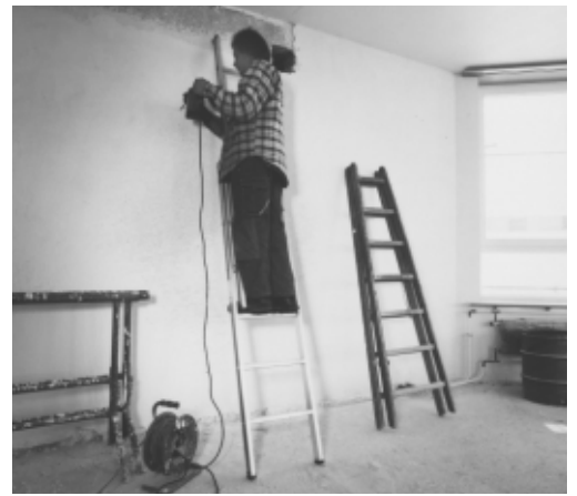
Wenn man eine Bockleiter als Anstell-Leiter benützt, wird durch die einseitige Belastung das Scharnier beschädigt.
