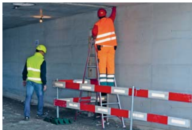
Bild 3: Sicherung der Leiter im Verkehrsbereich
